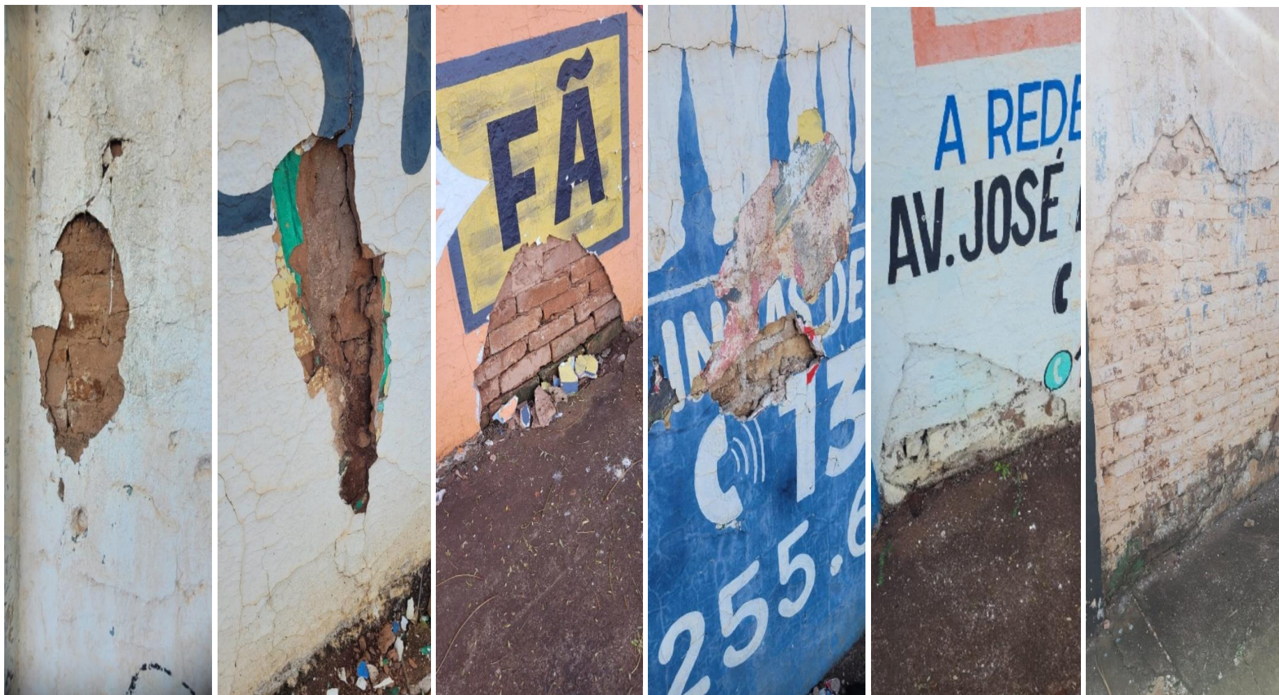
Reboque Totalmente Condenado na Av Santana dos Olhos D'Água
